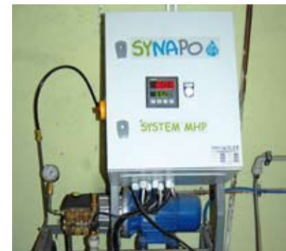
Szafa sterownicza z cyfrową regulacją i statym pomiarem wilgotności powietrza.
