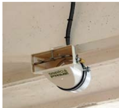
W różnych częściach hali zainstalowano dwuduszowe nawilżacze Prime z jednym wentylatorem.
