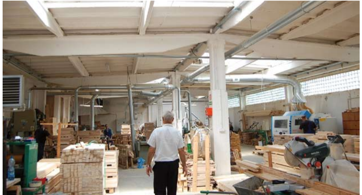
W głównej hali obróbki drewna zainstalowany jest wysokociśnieniowy system nawilżania powietrza Synapo MHP.
