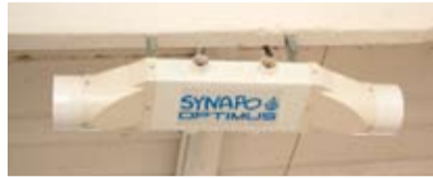
Nad wejściem do hali produkcji drabin zainstalowany został czterodyskowy nawilżacz Optimus z dwoma wentylatorami.
