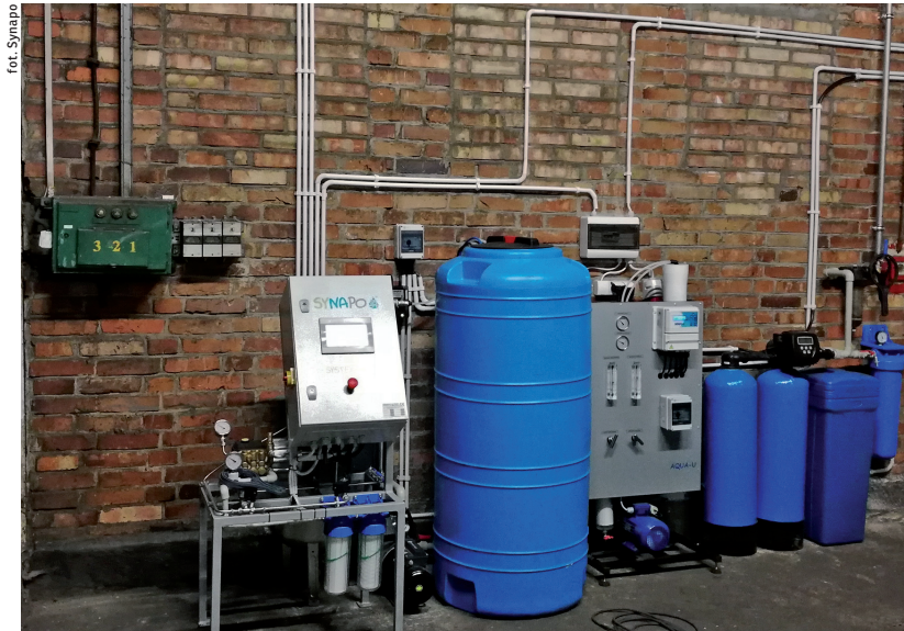
Systemy firmy Synapo wyposażone są w nowoczesne urządzenia filtrujące – stacje zmiękczenia lub stacje demineralizacji wody, które działają na zasadzie odwróconej osmozy.
